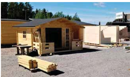
Tammistocenteriin on tänä keväänä pystytetty useita uusia mökkejä ja viikolla 22 on valmistumassa kaksi lisää.
